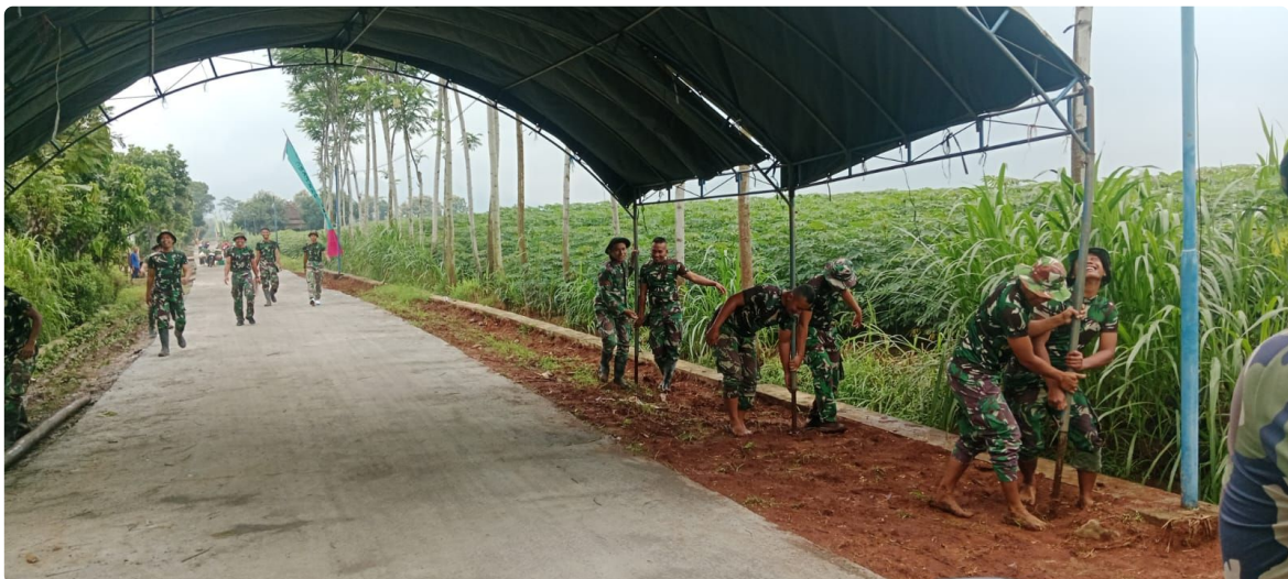
(Foto: Satgas TNI TMMD Reguler 119 Kodim 0718/Pati Tengah Melaksanakan Pemasangan Tenda Menjelang Peresmian Betonisasi Jalan Desa Tanjungrejo).
